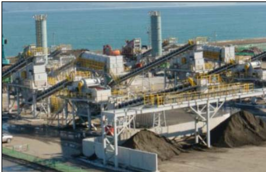
石巻ブロック土壌改質施設 (稼働開始: H24.7)
