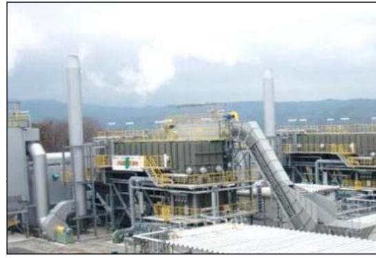
宮古市仮設焼却炉 (本格稼働開始: H24.3)
