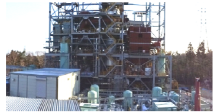
広野町仮設処理施設(平成27年1月)
