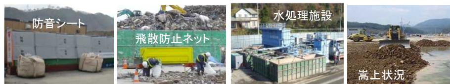
周辺環境対策の事例
