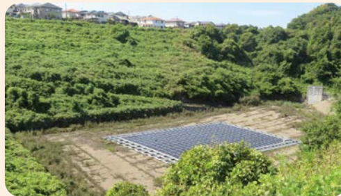
調整池のフロート太陽光発電設備 (神奈川県横浜市)
