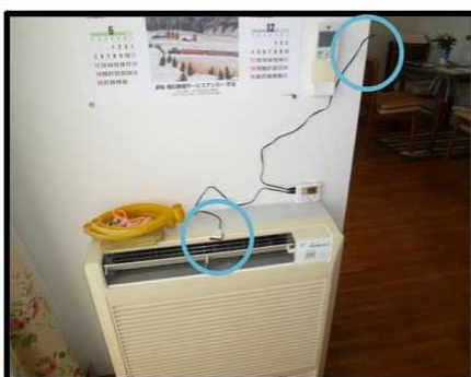
エアコンの吹き出し口
