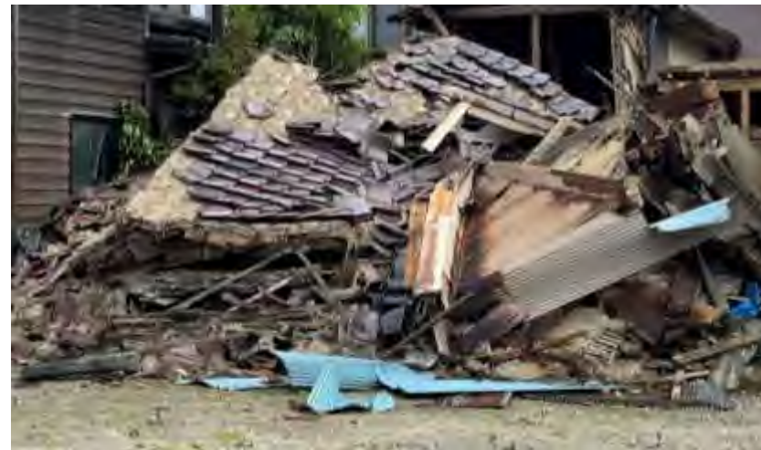
正院町 民家の屋根の崩壊 環境省撮影（令和5年5月6日）
