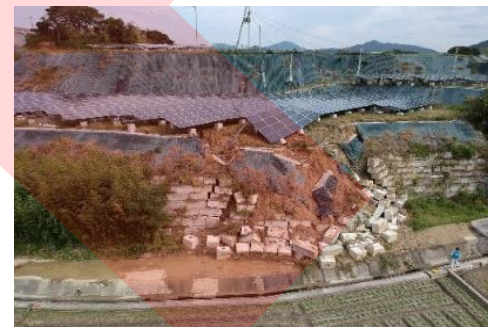
法面保護工が崩れて流出した事例
