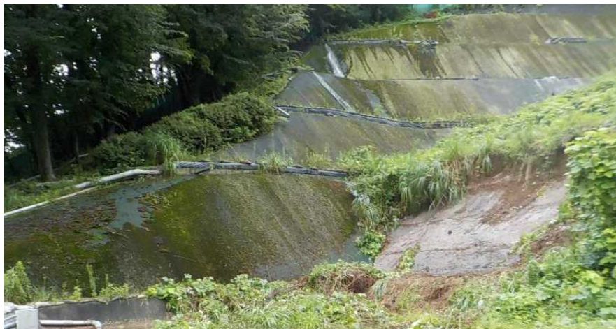
覆土が約80㎡崩落し、埋め立てた焼却灰が露出
