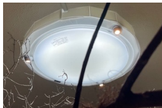
安全対策を施した照明
