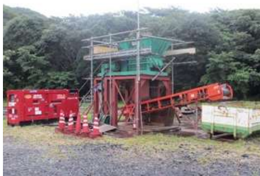
移動式破砕機 5 トン/日未満 非常用発電機も設置
