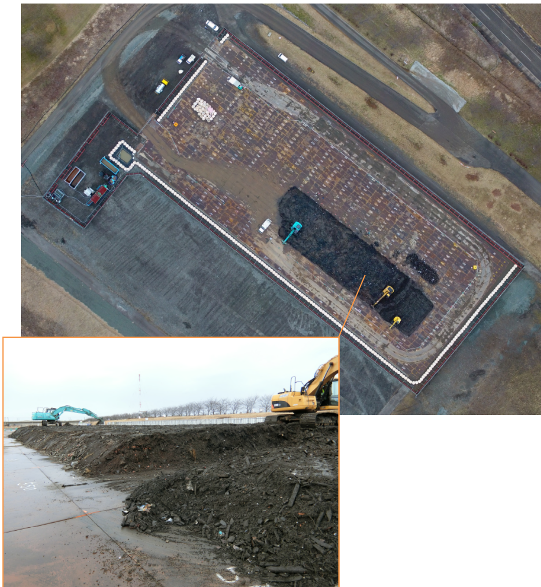
写真2-3-(1)-1 仮置場の全景及び燃え殻等の混合残さ
