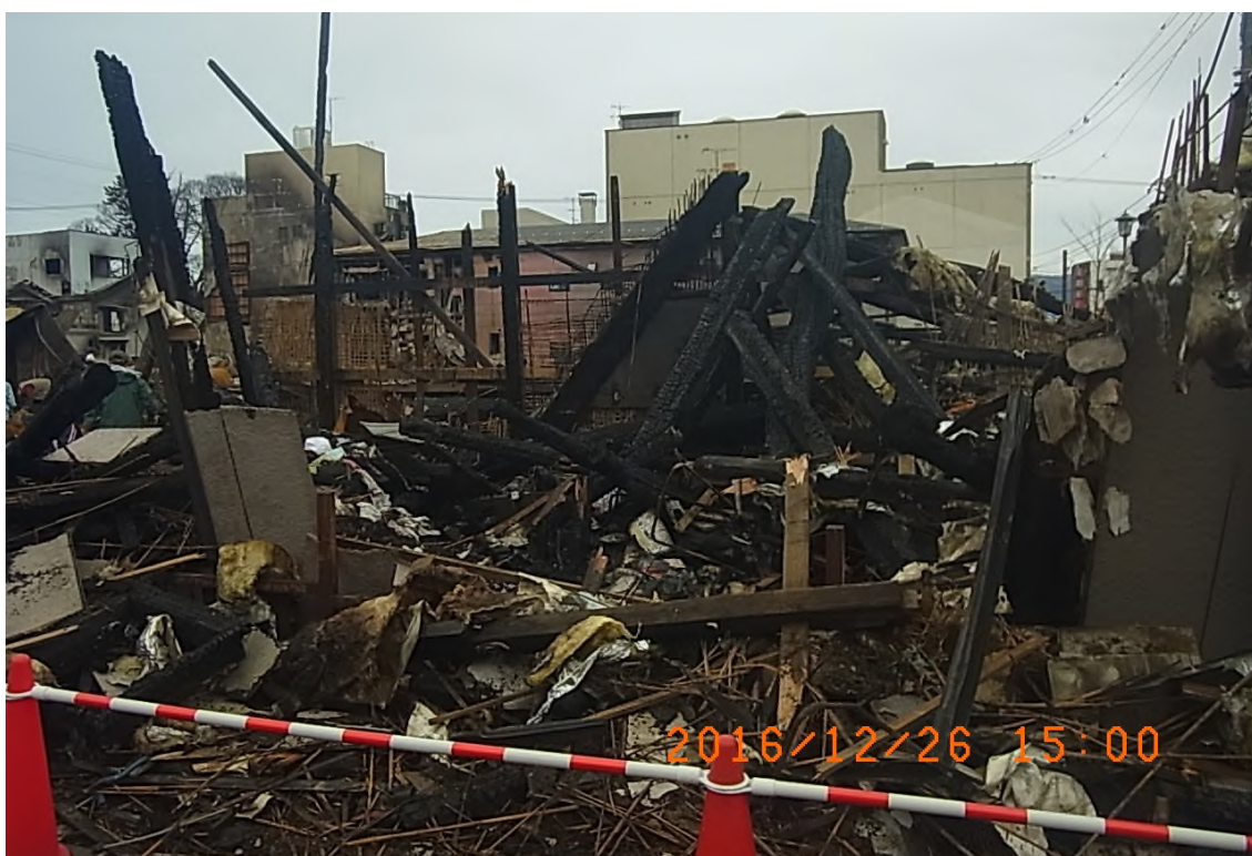
写真 1-1-(3)-2 2ブロックの被災状況
