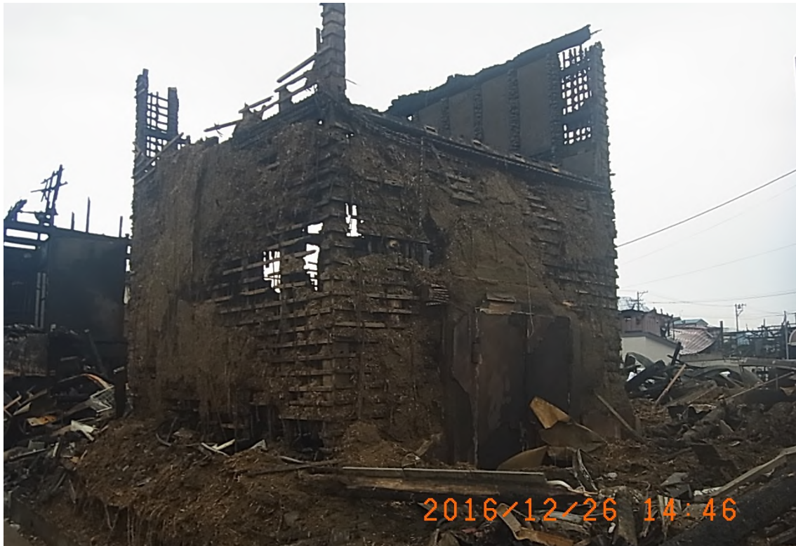
写真 1-1-(3)-3 3ブロックの被災状況（土壁構造の被災建物）
