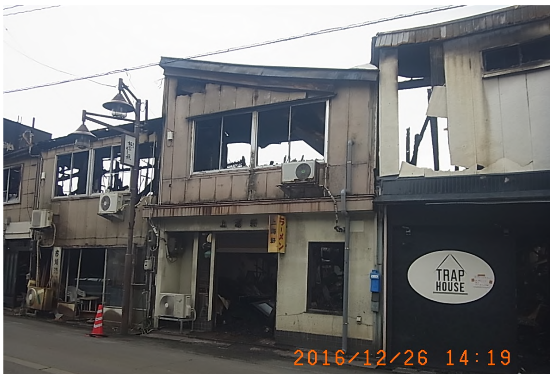
写真 1-1-(3)-5 5ブロックの被災状況（火元）
