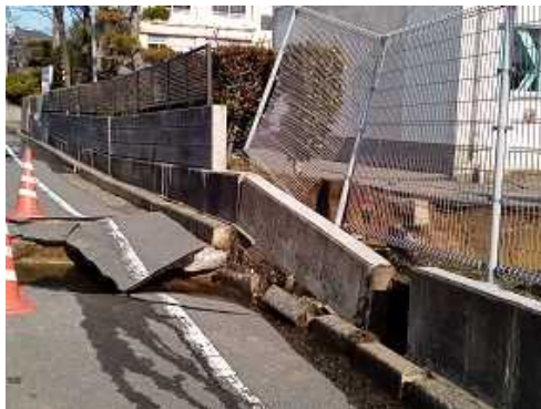
新潟県新潟市 路面の隆起 (1月2日)
