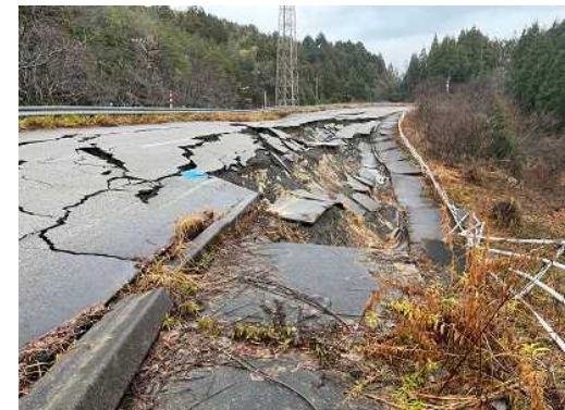
石川県七尾市 道路被害 (1月9日)
