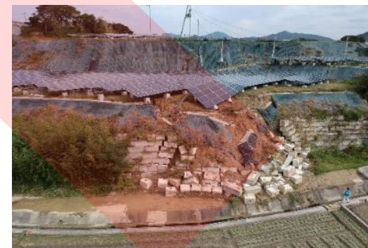
法面保護工が崩れて流出した事例
