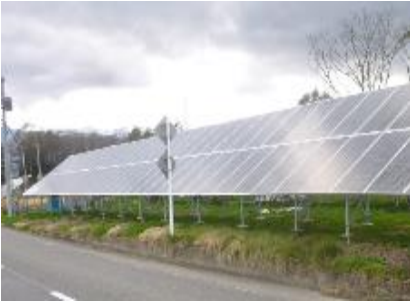
柵塀の設置されない設備
