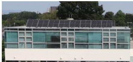
再生可能エネルギー（太陽光）設備
