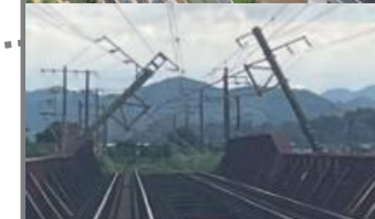
令和8年熊本地震の被害状況 (国土交通省ホームページから)
