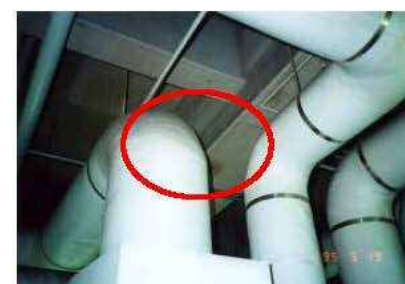
保温材（配管等）
