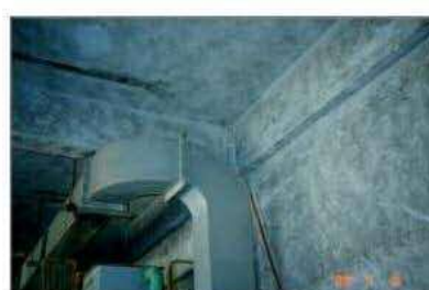
機械室の壁・天井の断熱
