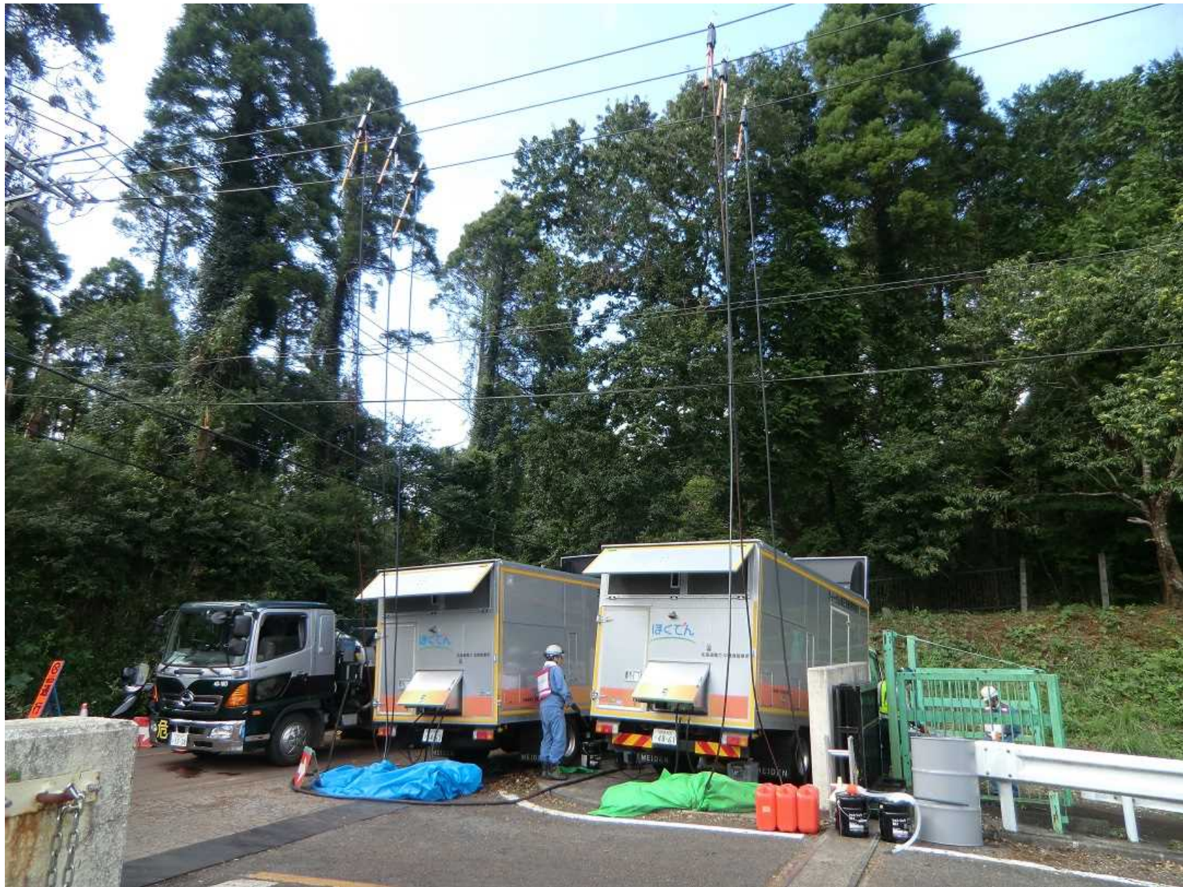
400KVA電源車2台+タンクローリー
