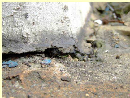
写真 1－4－1． アルゼンチンアリの巣が確認されたコンクリートのひび割れ
