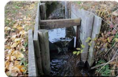
設置した三角堰
